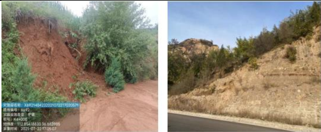
图 2 水流冲刷上边坡坍塌图
