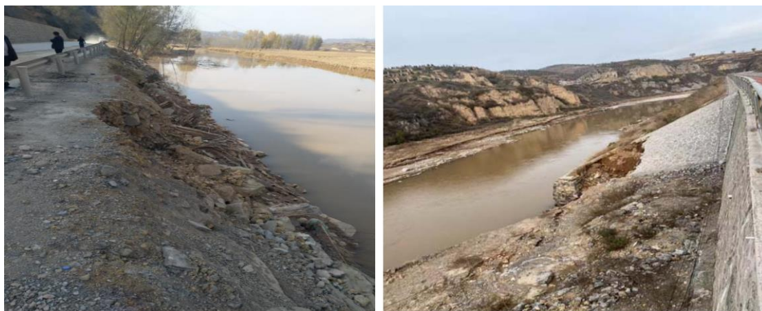
图 1 河流冲刷下边坡塌陷图
