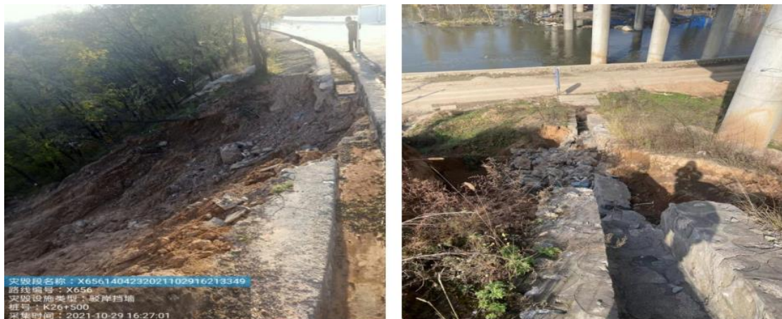
图 3 边沟、急流槽现状
