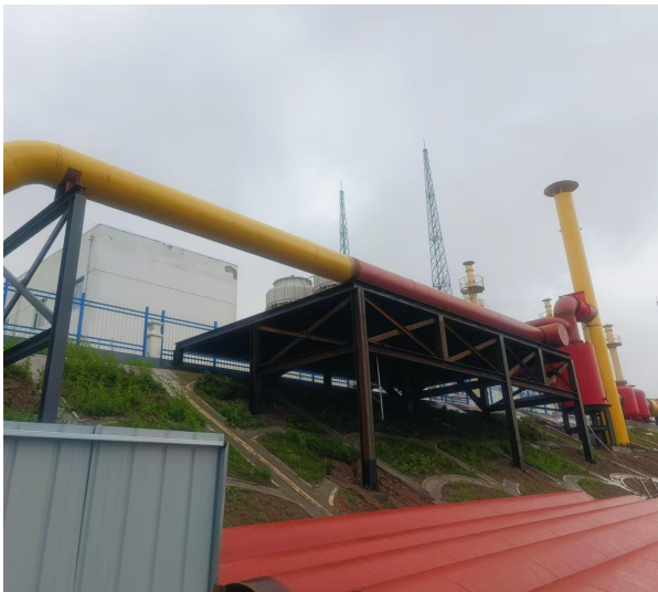
瓦斯抽放站管道
